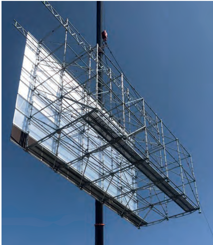
Komplettversatz eines RINGSCAFF-Gerüsts? Haken dran!
